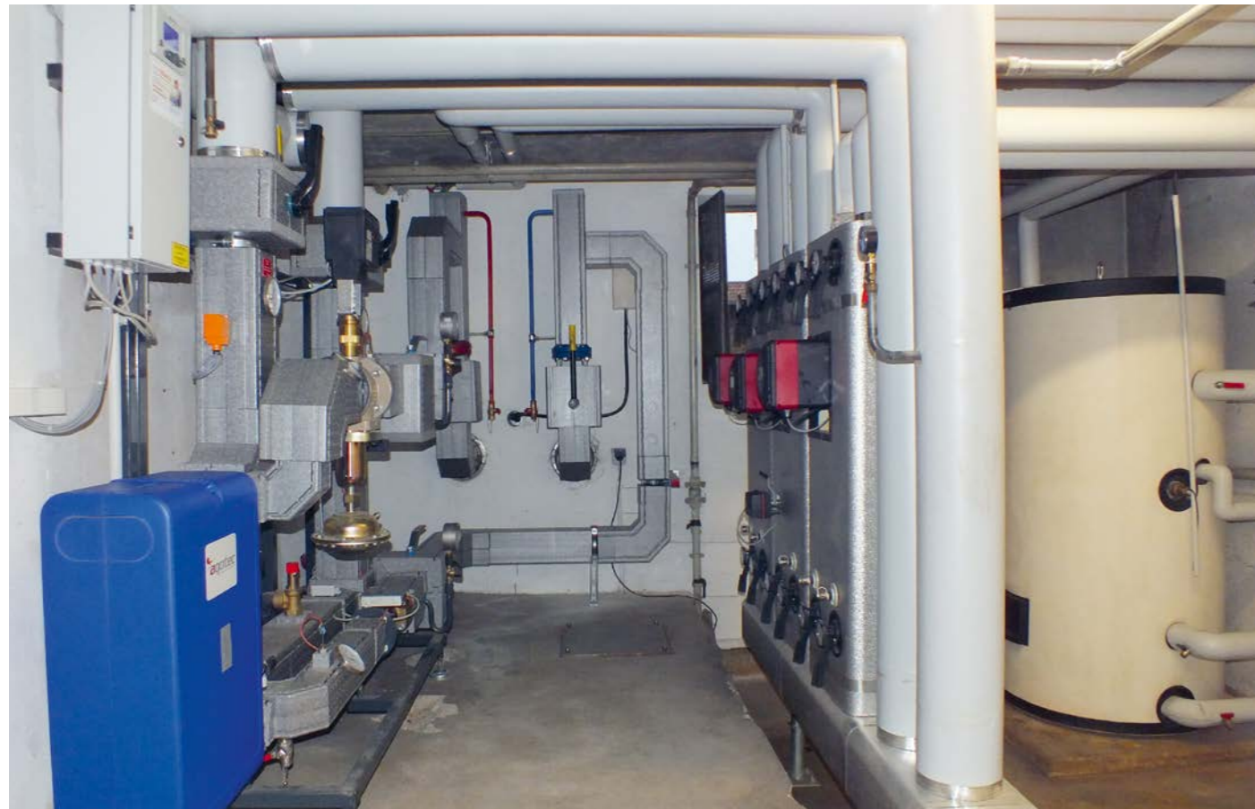
Heizungsanlage, Warmwasseraufbereitung und Verteilung im Keller eines Altbaus an der Schützenstraße mit einer Leistung von 600 kW. Ab einer Leistung von 150 kW werden die Übergabestationen für die Gebäude individuell angefertigt.
